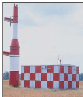
Energieversorgung auf dem Flughafen-Vorfeld
