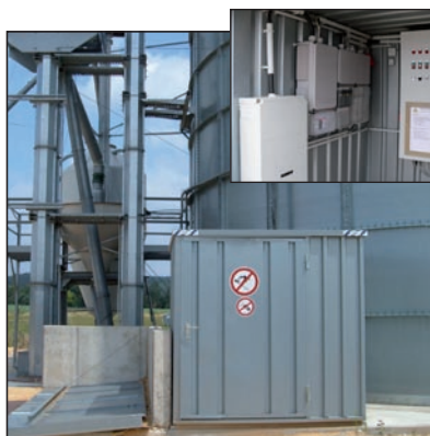
Modifizierter SC3000 als externe Schaltzentrale an einem Pelletsilo
